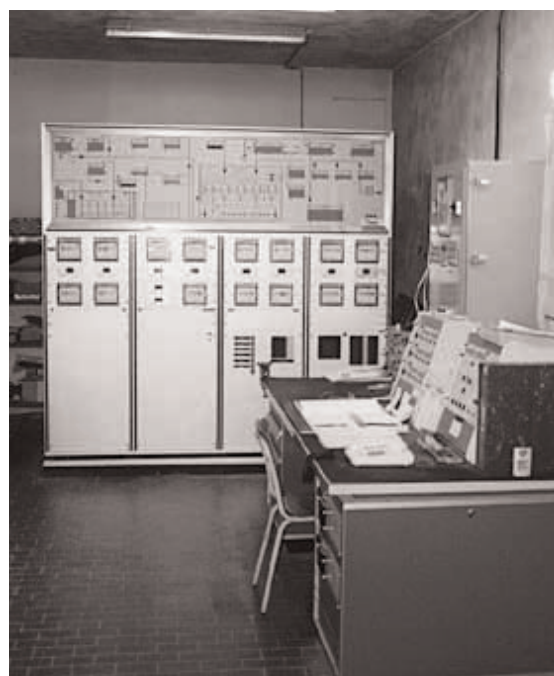
Folgaria - sala operativa di telecontrollo
