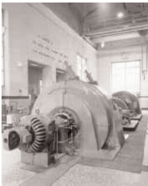
Le turbine della centrale di Carzano
