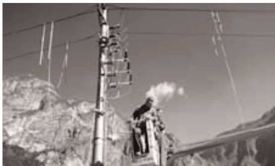
Grigno: elettrodotto a media tensione
