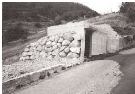
Cinte Tesino, acquedotto Masi
